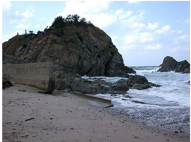
写真-10.真島の東側すぐのところのコンクリート壁。壁も割れ、足下は侵食されている。この辺りが砂採取②
